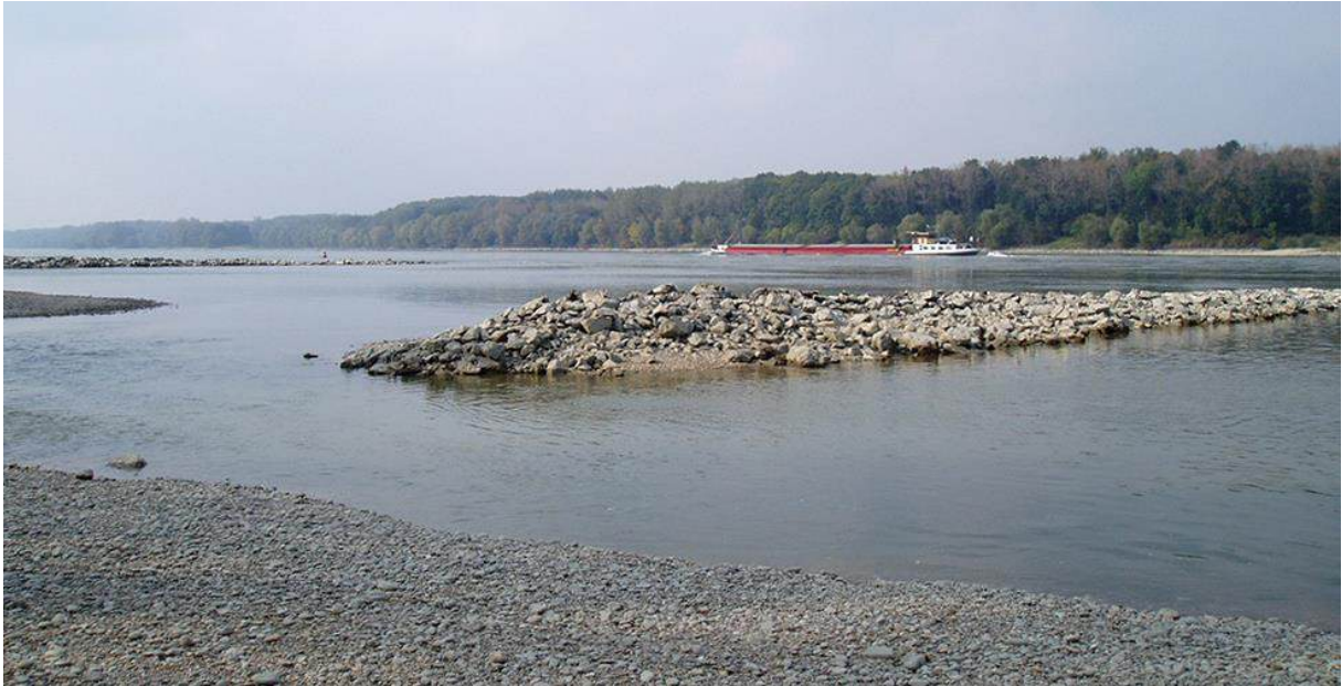
Abb. 154: Hinterströmte Buhne und dahinterliegend ungesichertes Kiesufer
